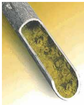
1. Verschmutzte Trinkwasserleitung mit starken Ablagerungen
